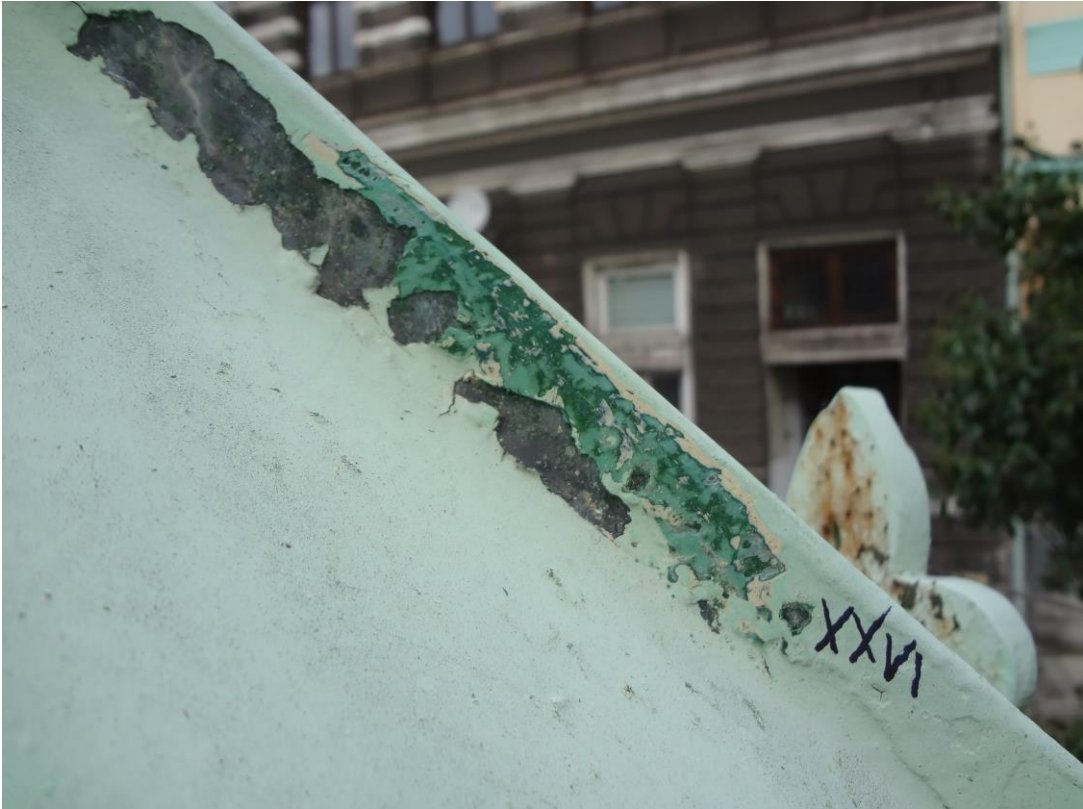
FOT. 35 - CIESZYN, STUDNIA TRZECH BRACI - odkrywka na stojącym rąbku łączenia blachy pokrycia dachowego.
