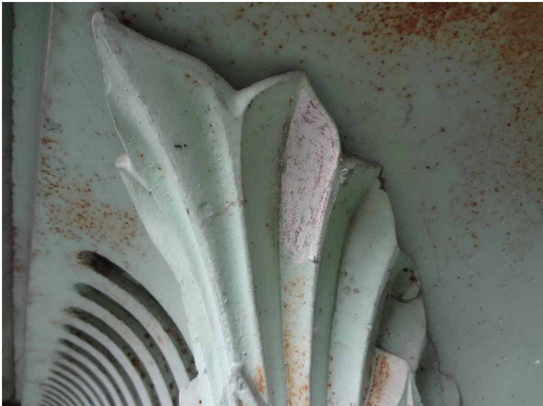
FOT. 16 - CIESZYN, STUDNIA TRZECH BRACI - odkrywka na narożnym elemencie w partii dekoracji pod okapem dachu.
