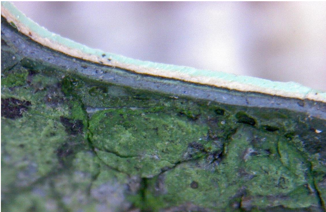
FOT. 38 - CIESZYN, STUDNIA TRZECH BRACI - zdjęcie mikroskopowe próbki pobranej z blachy pokrycia dachowego w partii stojącego rąbka.
