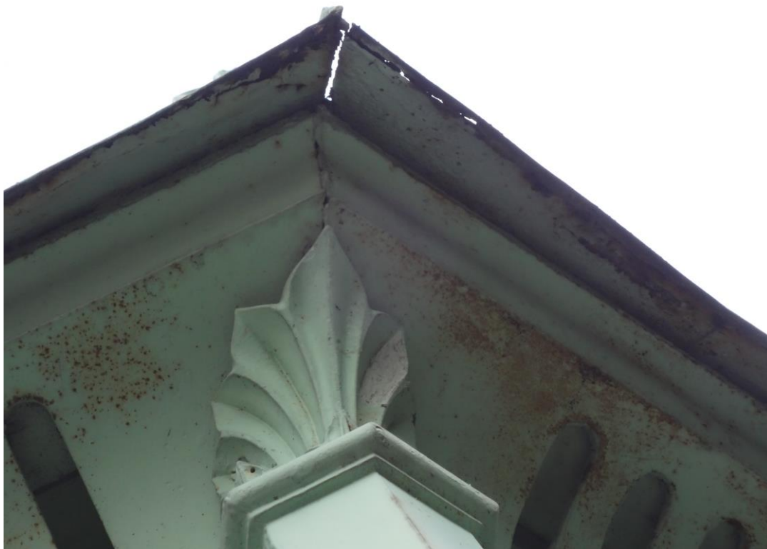
FOT. 41 - CIESZYN, STUDNIA TRZECH BRACI - narożnik pokrycia dachowego z widocznymi uszkodzeniami blachy i nieszczelnością okapu.
