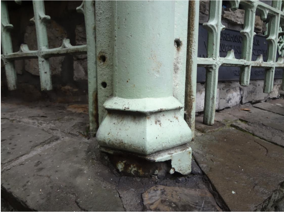
FOT. 43 - CIESZYN, STUDNIA TRZECH BRACI - baza lewej kolumny otwartego centralnego przęsła – widoczne uszkodzenia posadowienia i kamienia.
