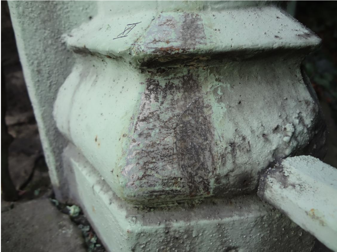
FOT. 21 - CIESZYN, STUDNIA TRZECH BRACI - odkrywka na bazie prawej kolumny prawego przęsła na styku z zewnętrznym ogrodzeniem,
