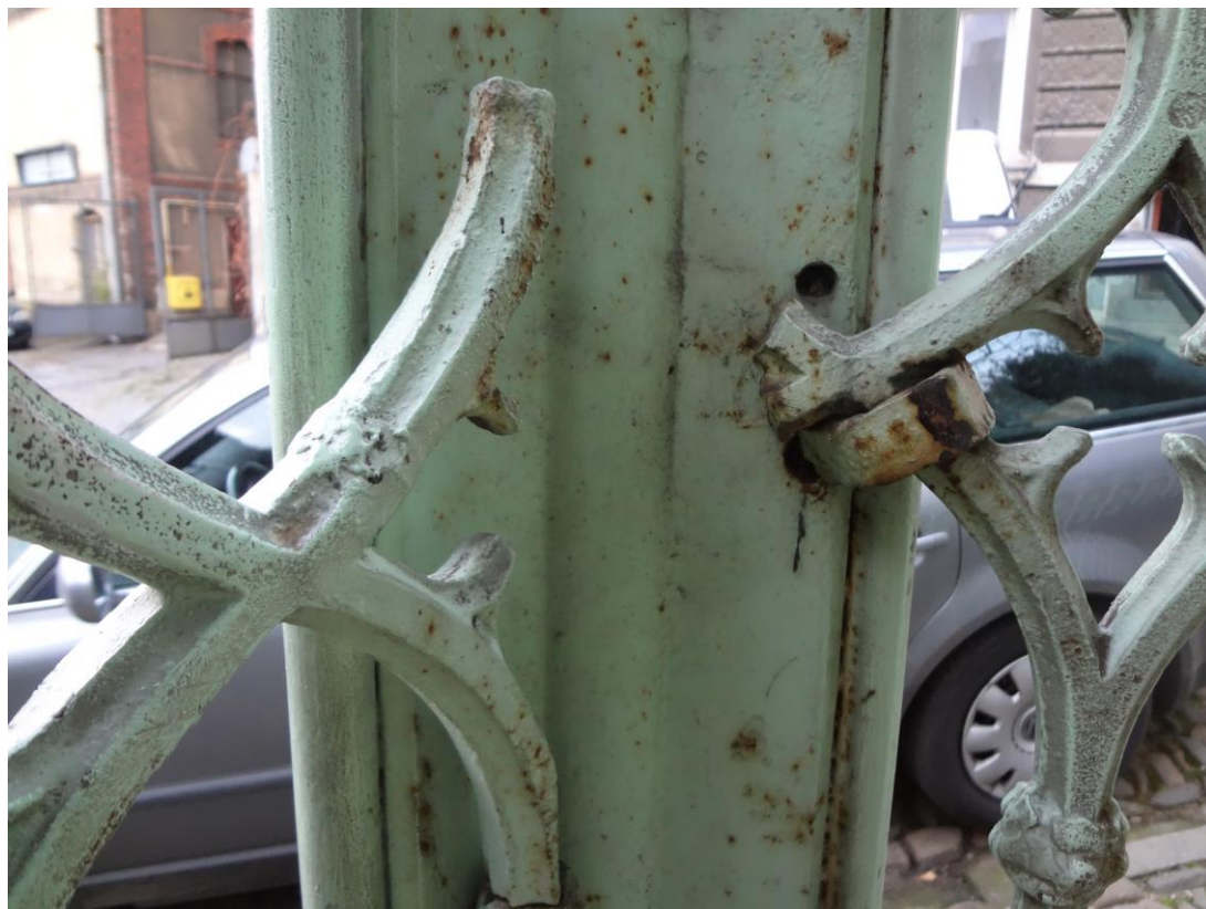
FOT. 40 - CIESZYN, STUDNIA TRZECH BRACI - wewnętrzne zamocowania krat w otwartych przęsłach. Widoczne wtórne niedbałe naprawy elementów.
