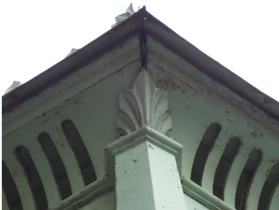
FOT. 42 - CIESZYN, STUDNIA TRZECH BRACI - narożnik górnego łączenia przęseł obiektu z widocznym, wtórnym rozsunięciem elementów.
