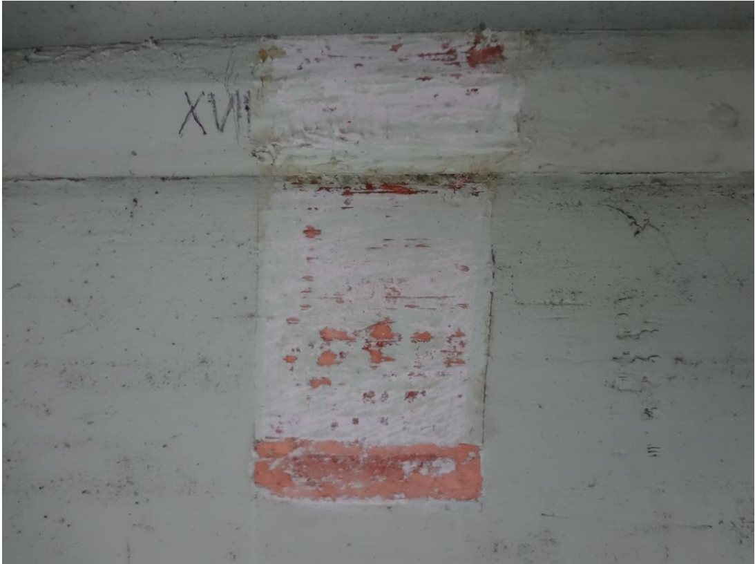
FOT. 27 - CIESZYN, STUDNIA TRZECH BRACI - odkrywka na drewnianych elementach więźby dachowej – deskowanie wewnętrzne sklepienia.
