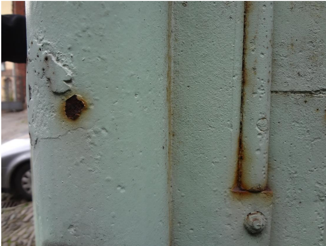
FOT. 44 - CIESZYN, STUDNIA TRZECH BRACI - korodujące elementy przęsła z łańciskim napisem – widok od strony zewnętrznej ( odwrocie ).
