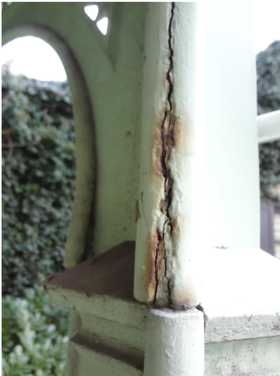
FOT. 45 - CIESZYN, STUDNIA TRZECH BRACI - podstawa wałka łuku między kolumnami otwartego przęsła centralnego - prawy skłon łuku - widoczne pęknięcia i deformacje formy spowodowane pęcznieniem korodującego żelaza.
