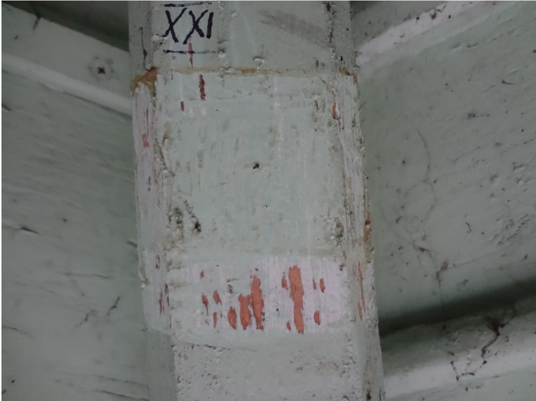
FOT. 31 - CIESZYN, STUDNIA TRZECH BRACI - odkrywka na drewnianych elementach więźby dachowej – belkowanie sklepienia ( krokiew ).
