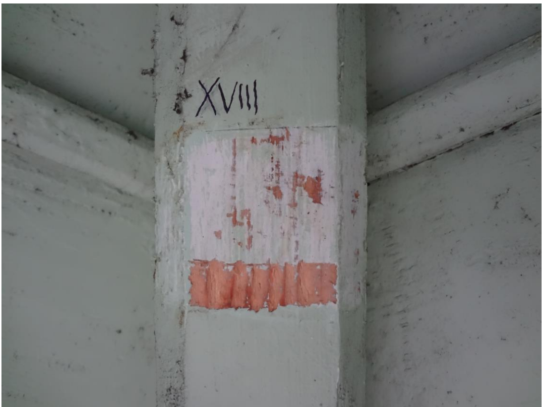
FOT. 28 - CIESZYN, STUDNIA TRZECH BRACI - odkrywka na drewnianych elementach więźby dachowej – belkowanie sklepienia ( krokiew ).
