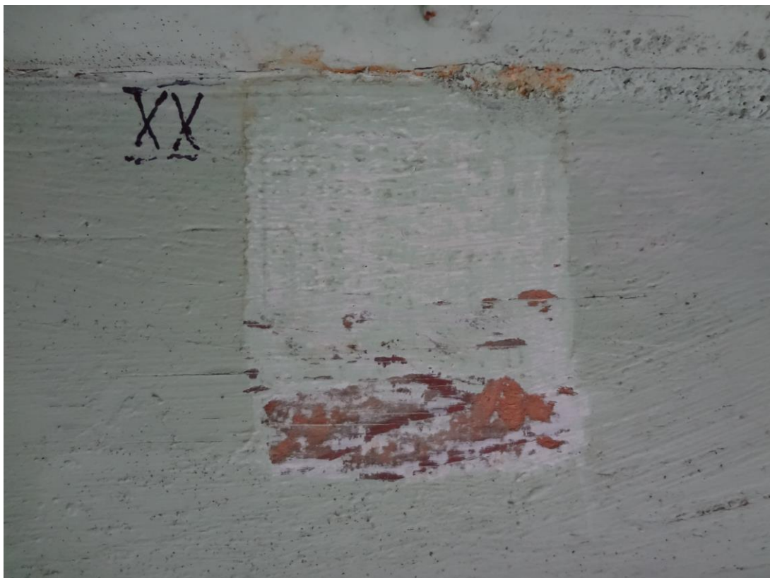
FOT. 30 - CIESZYN, STUDNIA TRZECH BRACI - odkrywka na drewnianych elementach więzby dachowej – deskowanie wewnętrzne sklepienia.
