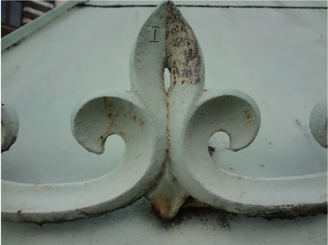
FOT. 11 - CIESZYN, STUDNIA TRZECH BRACI - odkrywka na elemencie dekoracji ponad okapem dachu.
